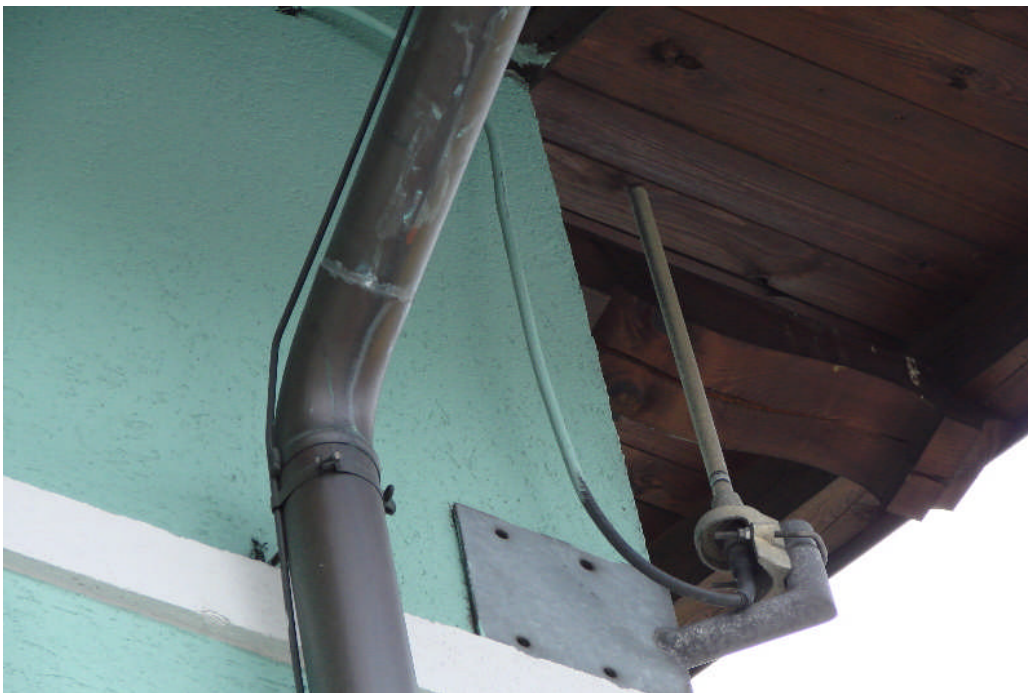
Abb.: GSM 900-Mikrozellen-Antenne direkt in der äußeren Ecke der an den Testraum angrenzenden Außenmauer. Diese Anlage lieferte das im Testraum prädominante GSM 900-Feld.
