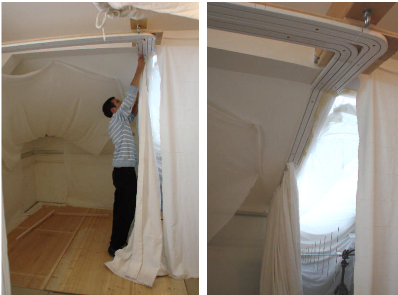
Abb.: Schienensystem für die Verschiebung der „Abschirmvorhänge“ und der davor angebrachten „Placebo-Vorhänge“
